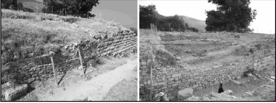
Resim 3 : Athena Caddesi destek duvarının kaldırılması. Abbildung 3 : Abtragen der Mauersteine an der Athenastraße vor Beginn der Arbeiten und am Ende der Kampagne 2013 (F. Schimpf).
