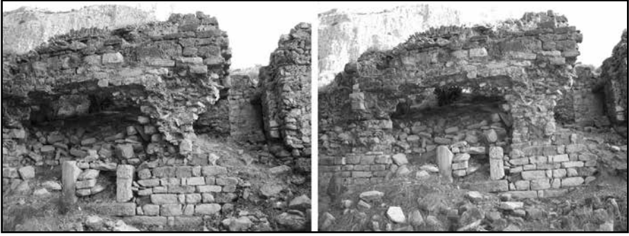
Resim 5 : Roma Hamamı. Destek ayağı kalınlığının artırılması, önceki ve sonraki durum. Abbildung 5 : Einsturzgefährdeter Südteil des römischen Bades vor und nach der Verbreiterung der Mauerpartie (A. Filges).
